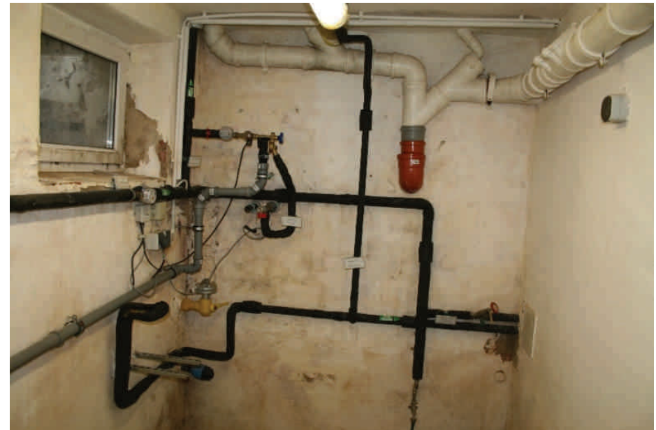
Feuchteschäden und nicht fachgerechte Installation
