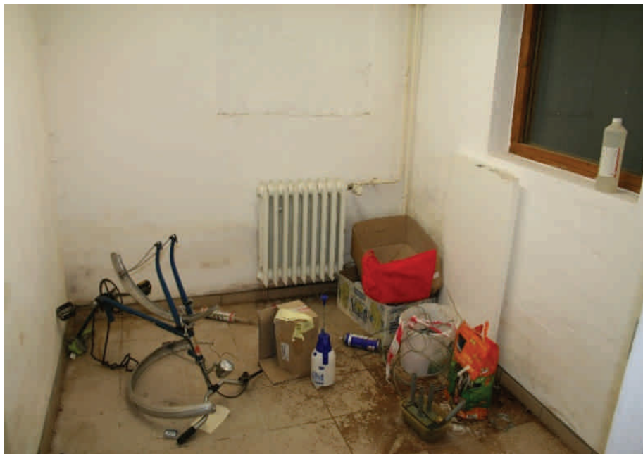
Nutzungseinschränkung durch Feuchteschäden
