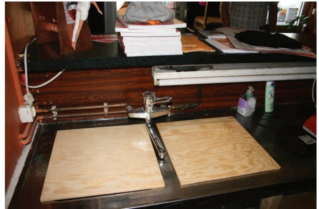
Sperrung der Küchenspüle wegen fehlender Abwasserleitung
