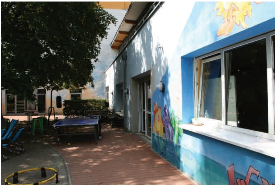
Fehlende Verschattung, mangelhafter Wärmeschutz
